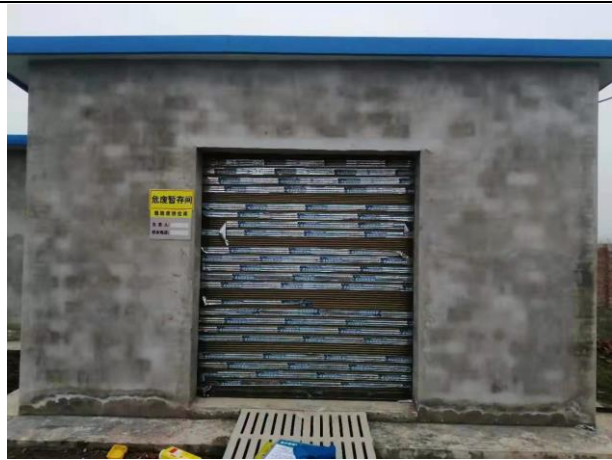
危险废物仓库
